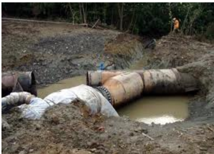
Obr. 5. Ocelové potrubí – přivaděče velkých průměrů představují kromě vlivu na životní prostředí i riziko pro provádění a opravy. (7)
